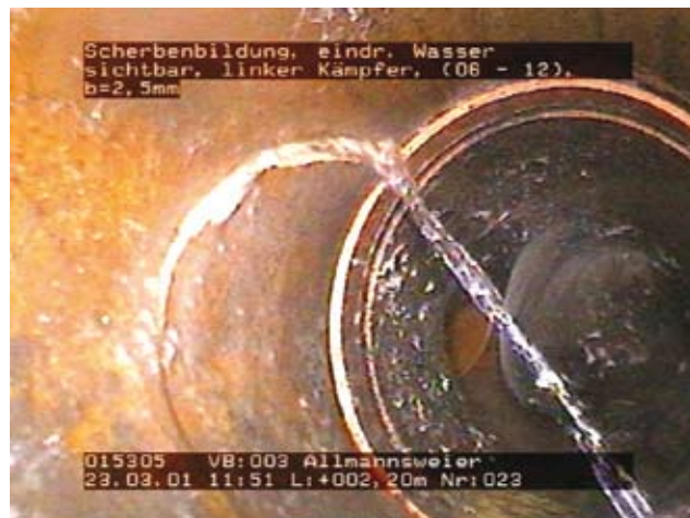
Abb. 21: Grundwasserinfiltration (Quelle: Gebr. Förster GmbH, Schwanaue)
