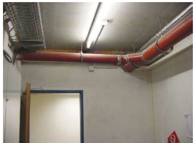
Abb. 28: Beispiel für ein unter der Kellerdecke abgehängtes Entwässerungssystem
