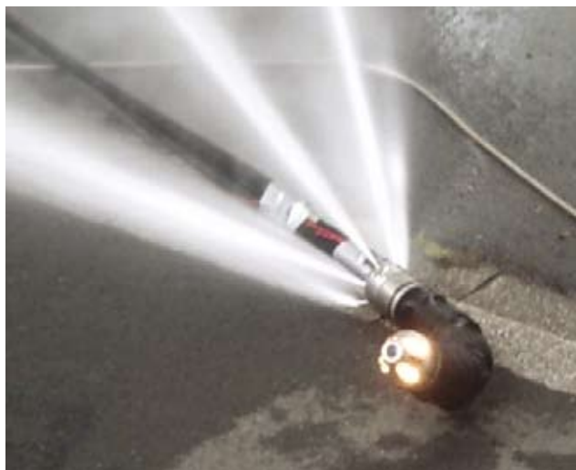
Abb. 25: „Göttinger Kanalwurm“ der Firma ZK Kanalprüftechnik GmbH
