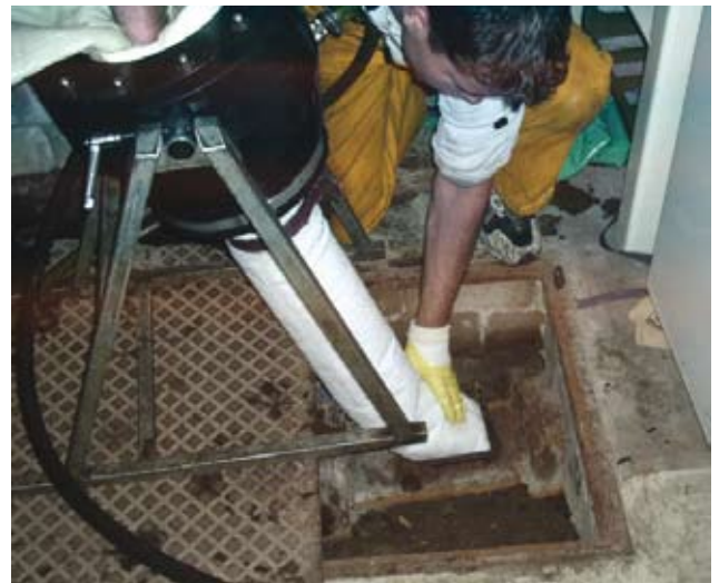
Abb. 27: Schlauchlinersanierung über einen Revisionschacht innerhalb eines Hauses: Inversion des Inliners (links), Freischneiden des Liners (rechts)
