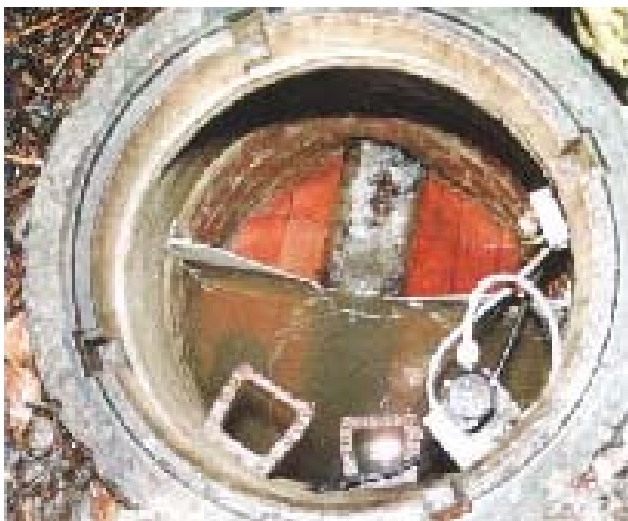
Abb. 6: Messschacht mit eingebautem Dreieckswehr und Wasserstandsmessung (für langfristige Messungen) (Quelle: IKT)
