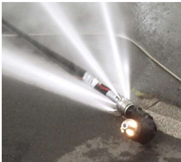
Abb. 60: „Göttinger Kanalwurm“ der Firma ZK Kanalprüftechnik GmbH
