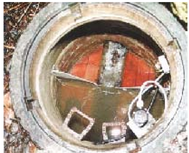
Abb. 19: Messschacht mit eingebautem Dreiecksmesswehr und Wasserstandsmessung
