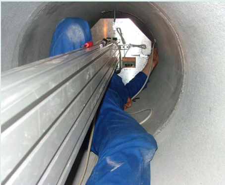
Bild 8 Einbau der Wegaufnehmerkonstruktion oben: Montage einer Messstafel an der Messbrücke unten: Positionierung einer Messstafel im Rohr
