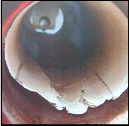
Abb. 9: Kurzliner nach Spülversuchen mit Winterstreusplitt
