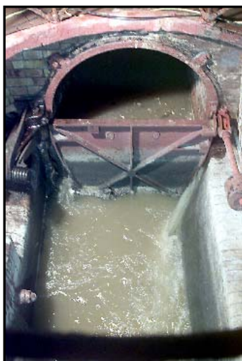
Abb. 2: Spültür in einem Eiprofilkanal
