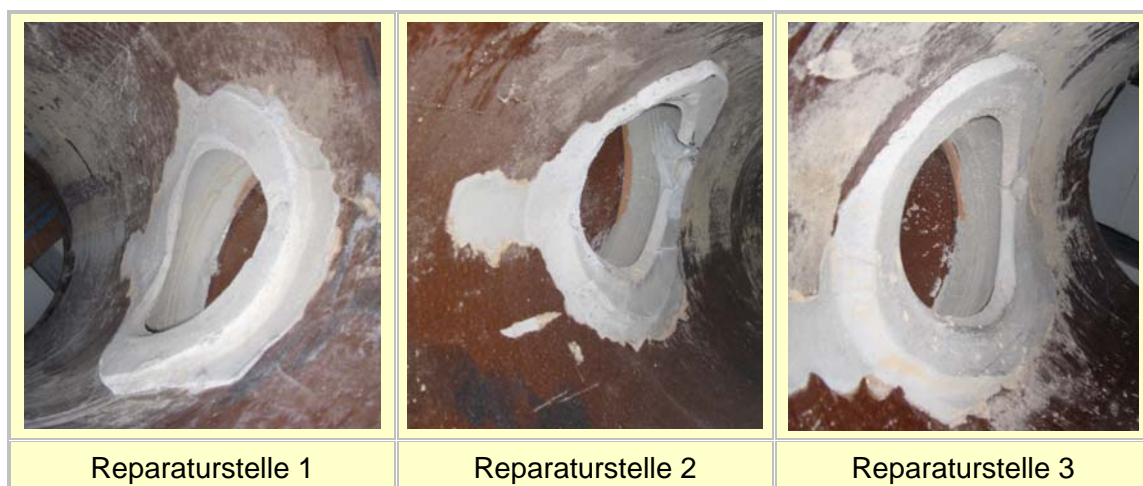
Abb. 5: Zustand der Reparaturstellen nach Hochdruckreinigung
