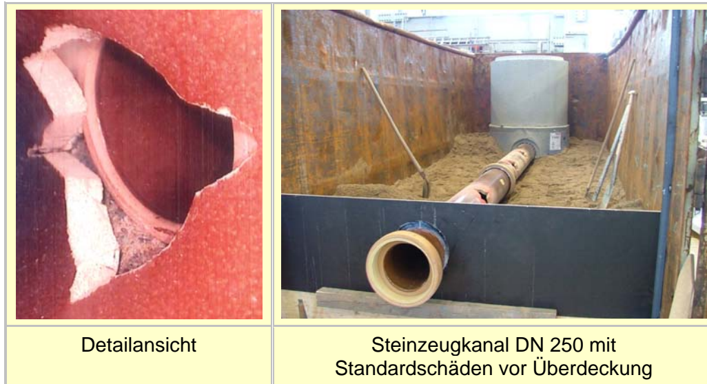
Abb. 4: Standardschaden: Starke Beschädigung des Bohrlochs durch Riss- und Scherbenbildung
