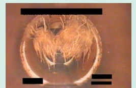
Wurzeleinwuchs am nicht fachgerechten, undichten Übergang
