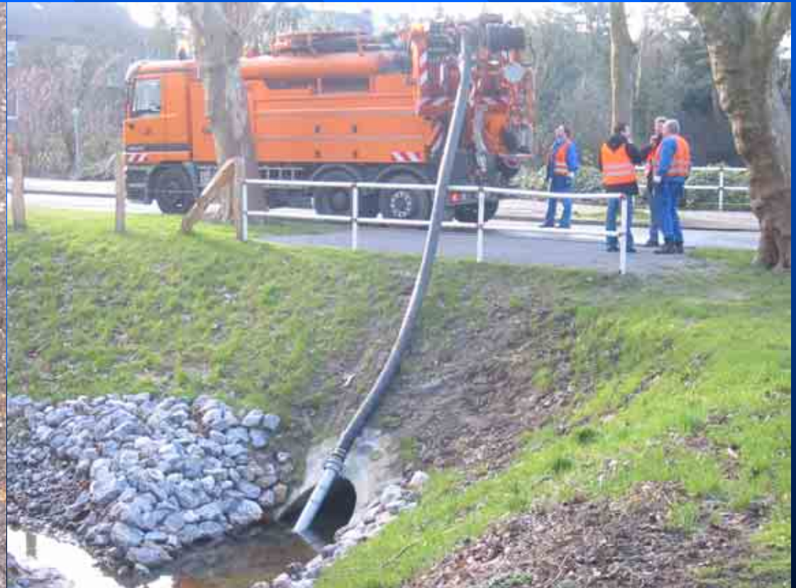
Spülwasserentnahme aus Gewässer!
