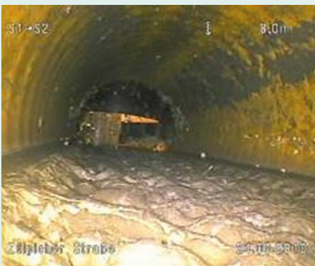
Ohne Reinigung und Wartung: Sedimente in der seit 2006 betriebenen Sedi-Pipe-Anlage in Köln
