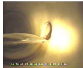
Defekter Hausanschlussstutzen Öffentlicher MW-Kanal
