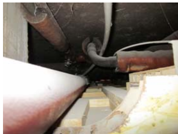
Hindernisse bei den Flurquerungen (Kabel, Heizungsrohre, Wasserleitungen)
