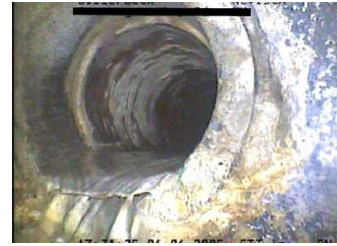
C) starker Fremdwasserzufluss
