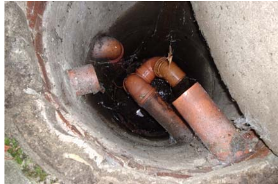
ungünstige Lage der Schachtanschlüsse, Beispiel
