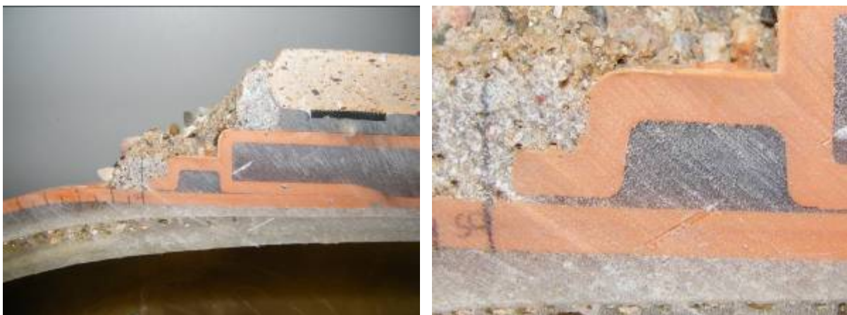
Abbildung 2: Harzaustritt aus einer undichten Verbindung
