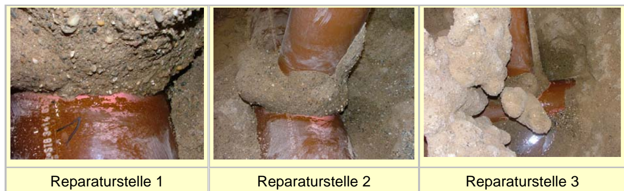
Abb. 6: Wasseraustritt an den freigelegten Reparaturstellen
