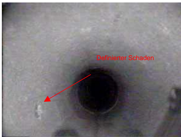
Bild 9: Auffinden des Schadens aus der Sicht der „Sehenden Düse“
