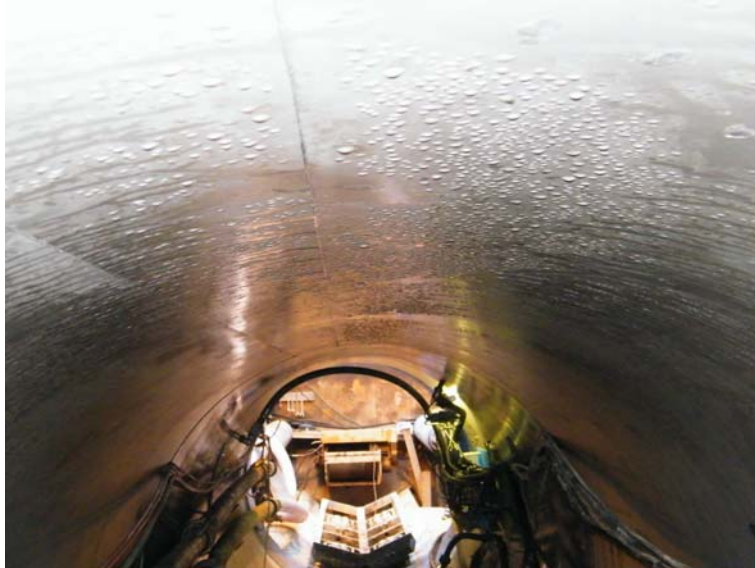
Bild 17: Kondensat innerhalb des Rohrstranges
