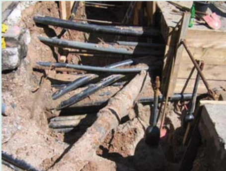
Figure 2: pipelines criss-crossing the underground Source: Heidelberger Versorgungs- und Verkehrsbetriebe GmbH
