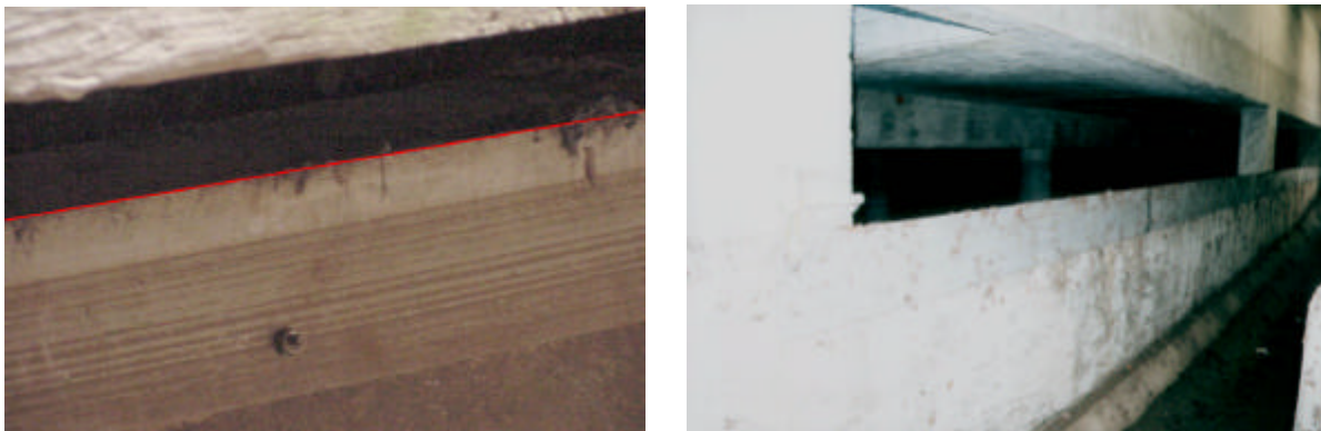
Abbildung 18: Beispiele für Verschmutzungen im Bereich von Entlastungsschwellen (rot)
