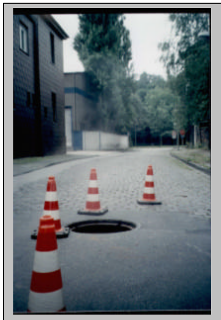
Bild 13: Dampfaustritt aus dem Einsteigschacht
