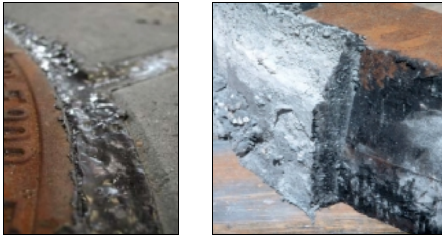
Abbildung 5: Vergussfuge nach Abschluss der Laboruntersuchung
