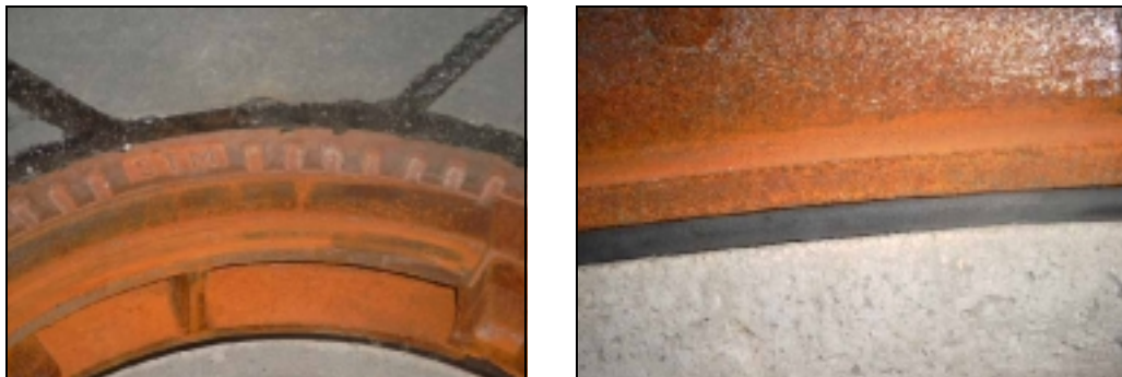
Abbildung 6: Vergussfuge und Elastomerring unter dem Schachtrahmen nach Abschluss der Laboruntersuchung
