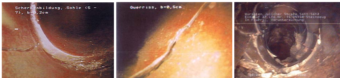
Bild 4: Schadensbilder zu Hausanschlussleitungen, Beispiele
