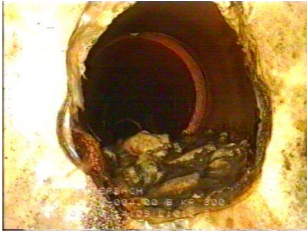
Bild 57: Nicht sanierter Einbindungsstelle
