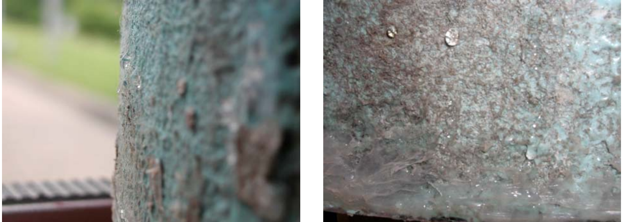
Bild 48: Austritt von Wasser an der Außenoberfläche eines nicht-fachgerecht getränkten Liners (vgl. Bild 42) unmittelbar nach der Wasserbefüllung des Rohrabschnittes
