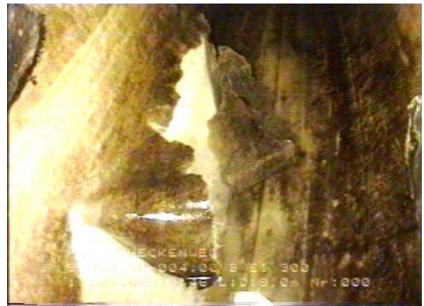
Bild 56: Ablösung der Innenfolie
