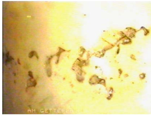
b) Luftnester sichtbar auf innerer Rohrwandung
