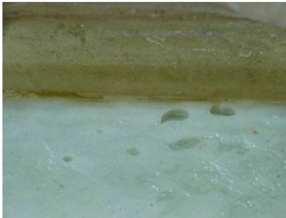
a) Luftnester unter Außenfolie
