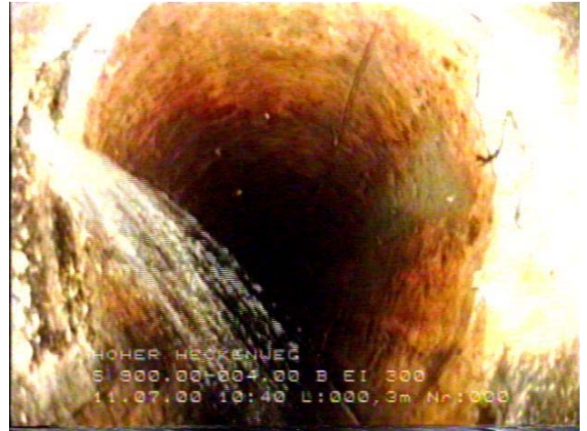
Bild 58: Sichtbar undichte Schachtanbindung
