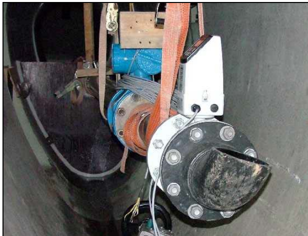
Abbildung 9: Messrohr und Absperrklappe, MID und Drucksensor
