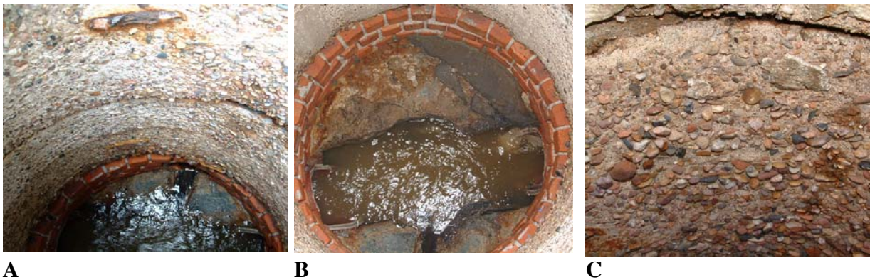
Abb. 18: Ausgangssituation: Korrodierter Abwasserschacht aus Betonfertigteilen. A: Blick in den Schacht. B: defektes Gerinne und defekte Berme. C: Korrosion der Schachtwandung.
