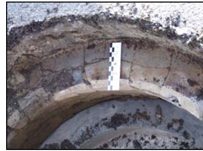
Abb. 4: freigelegte Mörtelfuge mit Rissen
