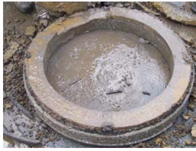
Abb. 10: Ausgebohrte Schachtabdeckung mit Mörtelfuge und Ausgleichsring
