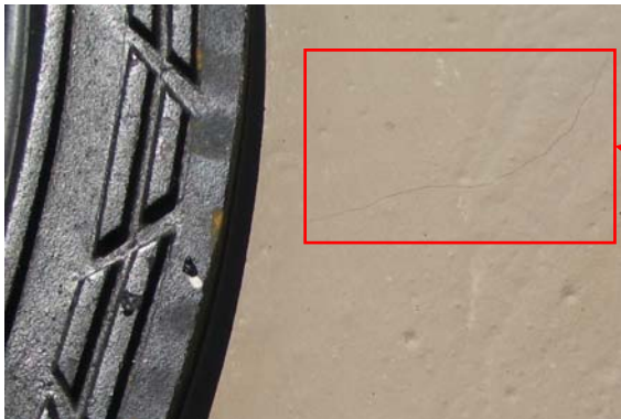
Abb. 22: Rissbildung unmittelbar nach Verguss
