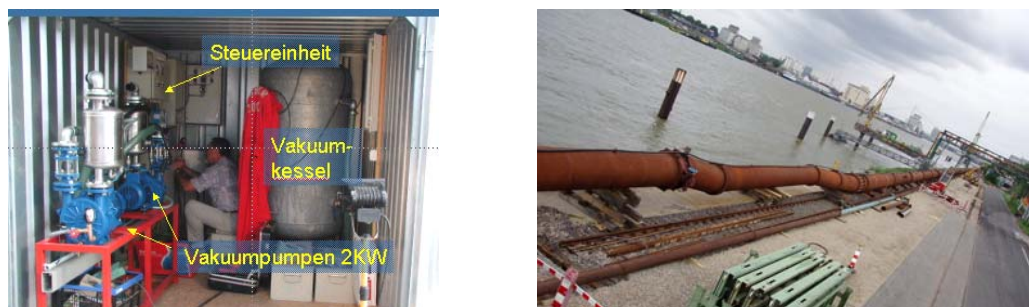
Abb. 1: Komponenten eines Heber 2000 auf dem Betriebsgelände der BASF AG in Ludwigshafen, links: Betriebsgerät, rechts: Leitung DN 1400, Fotos: [6]
