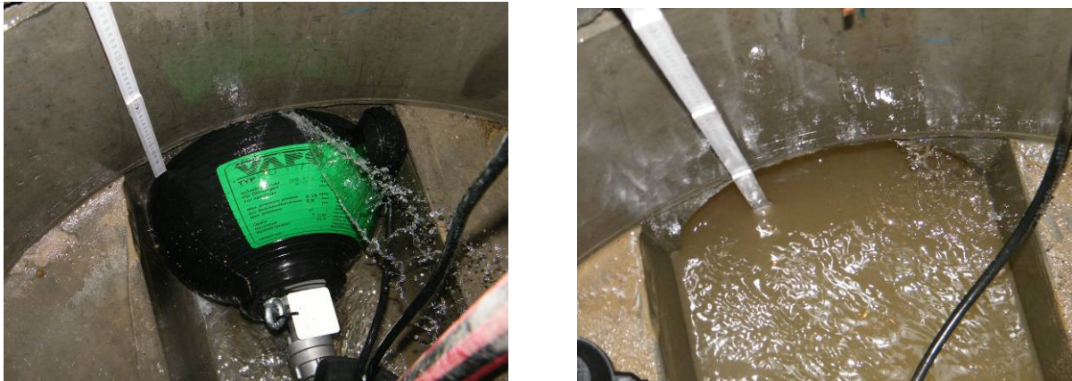
Bild 4 Undichte Rohranbindung DN 300 mit Wassereindrang durch Schadstellen vor der Abdichtung: Absperrblase zur vorübergehenden Abdichtung (links); Starker Wassereindrang unmittelbar nach dem Entfernen der Blase (rechts)
