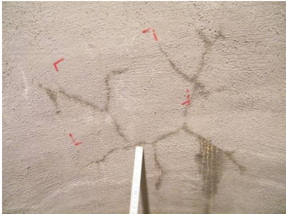
Bild 7 Mineralische Beschichtung im Bereich, an dem der Verbund mit Trennmittel planmäßig geschwächt wurde: Rissbildung in Verbindung mit Feuchtefahren
