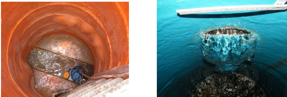
Bild 8 Polymere Beschichtungen in Bereichen, an denen der Verbund mit Trennmittel planmäßig geschwächt wurde: Blasenbildung mit fortschreitender Ablösung (links) und Aufreißen der Beschichtung (rechts)
