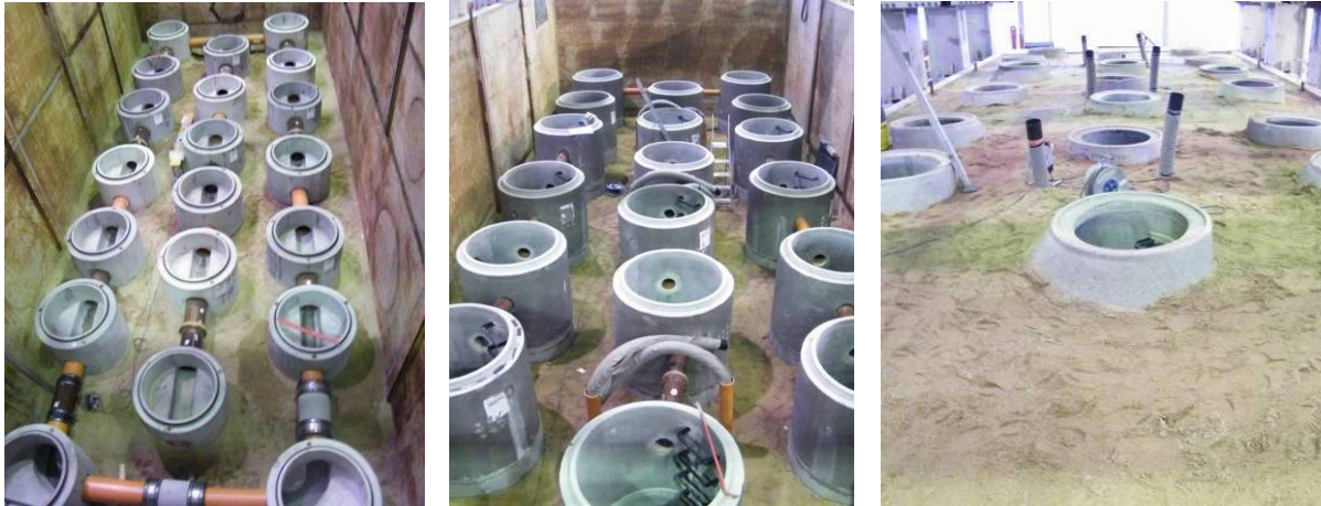
Bild 2 Einbau der Schächte im Großversuchsstand: Untere Rohrlage DN 300 (links); Mittlere Rohrlage DN 150 (mitte); Fertiggestellter Einbau (rechts)
