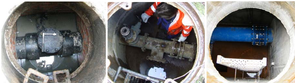
Abb. 3: Revisionsöffnung (li), T-Stück und Spülstutzen (mi) und Passstück (re) in Gussleitungen
