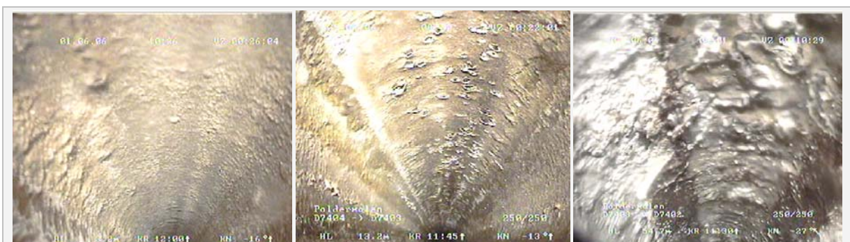
Abb. 8: Blasenbildung (links, mittig) und Ablösen von Material (rechts) der Rohrwand einer Trinkwasser-Asbestzementleitung [17]
