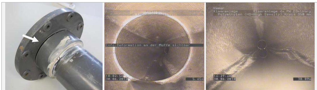
Abb. 6: Rissbildung in einer Flanschverbindung eines PVC-Abwasserdruckrohres in der Pumpstation (links) [15], Ovalisierung (mittig) und Deformation durch Punktlast in einer PE-HD-Abwasserdruckleitung (rechts)
