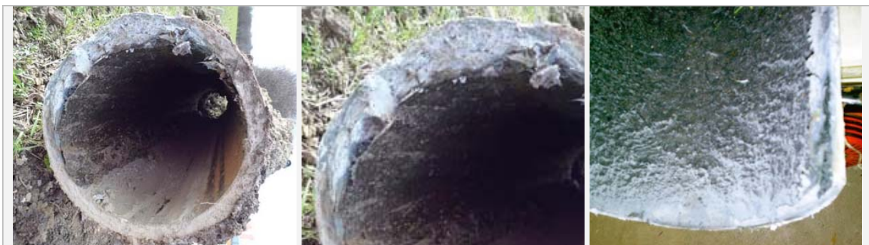
Abb. 7: Gequollenes Asbestzementrohr einer Abwasserdruckleitung (links, mittig) [16] und Ausschnitt eines korrodierten Asbestzementrohres einer Abwasserdruckleitung [15] (rechts)
