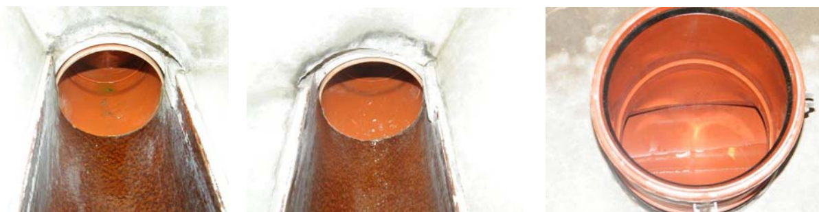
Abbildung 8: Blick in den Zulauf (links), Ablauf (mitte) und Regenwasserkanal (rechts)
