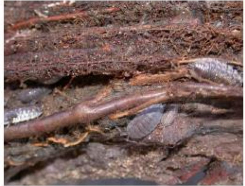
Abb. 125: Wurzeln haben die Zwischenräume in der Rohrverbindung ausgefüllt (im Scheitel der Leitung). Außer Wurzeln befinden sich hier lebendige Kellerasseln.
