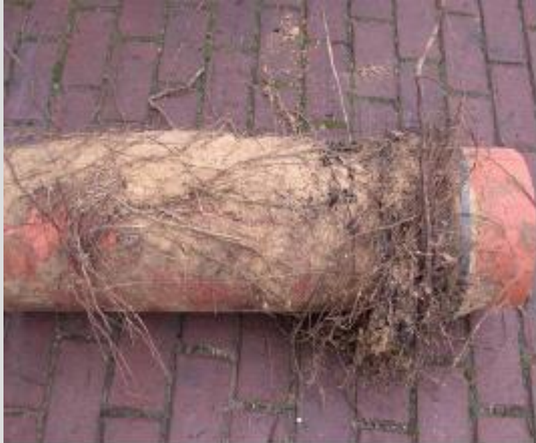
Abb. 73: Durchwuzelte Rohrverbindung als Leitungsprobe aus einem Mischwasserkanal. Die Wurzeln haben sich auf dem Scheitel der Leitung und am Rand des Überschiebringes ausgebreitet.
