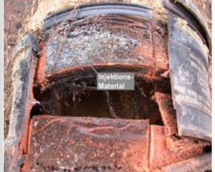
Abb. 74: Die Wurzeln haben innerhalb des Überschiebringes ein Geflecht gebildet und nahezu alle Räume ausgefüllt.
