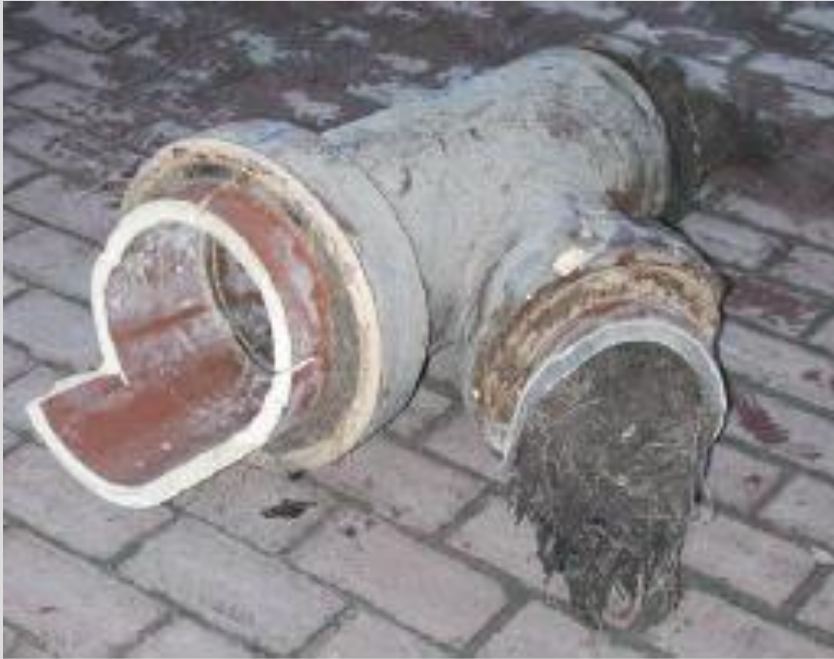
Abb. 106: Wurzeln haben einen nicht in Betrieb befindlichen Zulauf im Abzweig eines Schmutz-wasserkanals verstopft. Die Wurzeln haben gleichmäßig den gesamten Querschnitt ausgefüllt.
