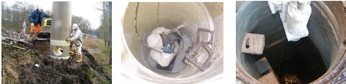
Bild 10 Impressionen der In-situ-Prüfungen: GFK-Innenschachtsystem, Kunststoffbeschichtung, maschinell aufgebrachte Mörtelbeschichtung (von links nach rechts)
