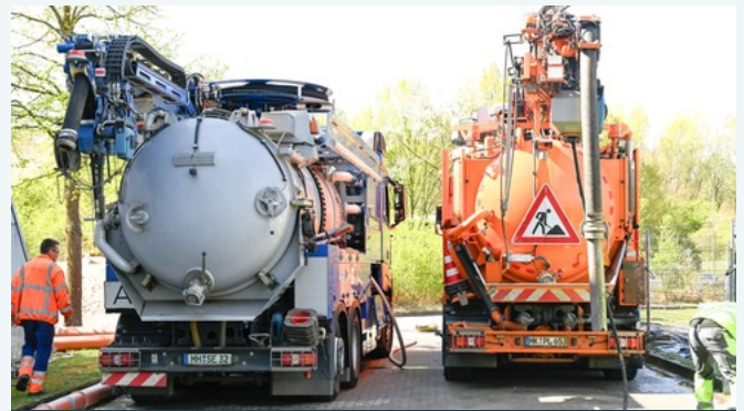
MEHR REINIGUNG, WENIGER WASSER
